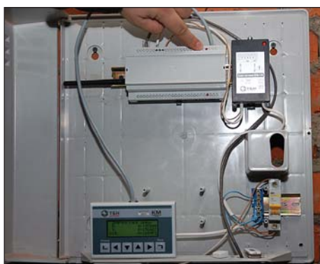
Рис. 9. Домовой контроллер КМ-ДZ с подключенной операторской панелью
